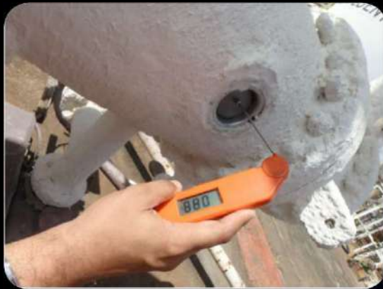
Inspektionsöffnung No. 2 – Temperatur auf Oberfläche: 88°C
