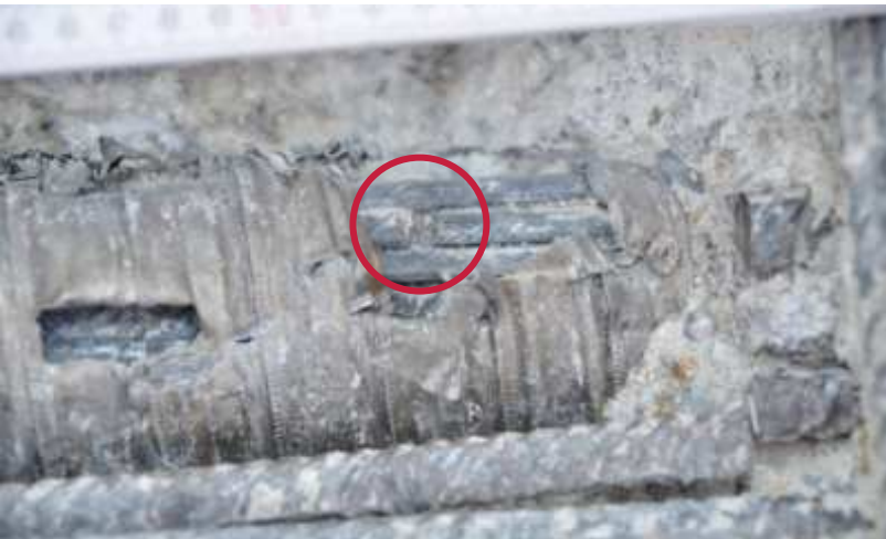
Drahtbrüche beim Öffnen des Spannglieds
