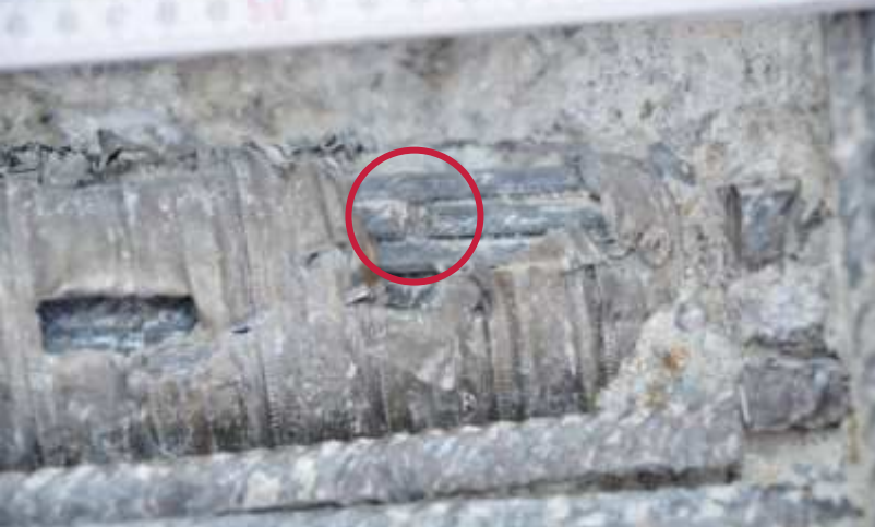
Drahtbrüche beim Öffnen des Spannglieds
